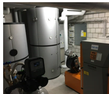
Wärmeerzeugung und Warmwasseraufbereitung Haus A
