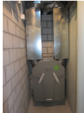
Zehnder Wärme- rückgewinnungsgerät mit Schalldämpfern
