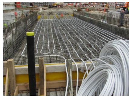
TABS in der Bodenplatte
