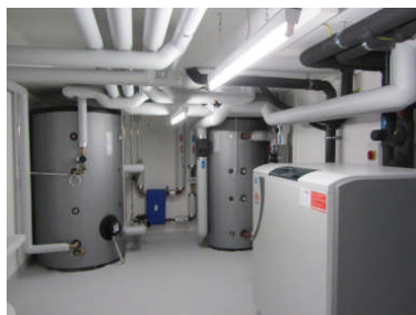
Sole -Wasser Wärmepumpe, Puffer- und Brauchwarmwasser-Speicher
