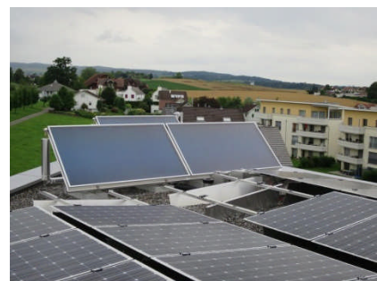
Thermische Solar- und Photovoltaikanlage auf dem Dach
