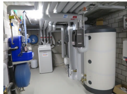
Der Blick in die Technikzentrale, mit Wärmepumpe und Warmwasseraufbereitung.
