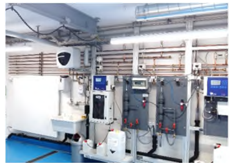
Analyseraum mit Kupferverrohrung
