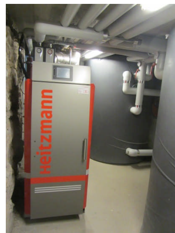
Stückholzheizkessel im Heizraum UG
