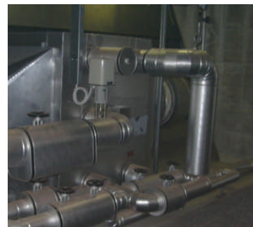
Rauchgaserhitzer SVA 350 kW
