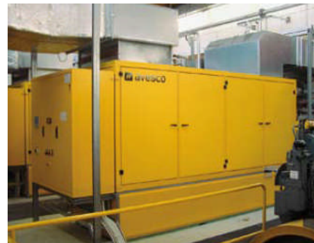
BHKW 280 kW elektrisch
