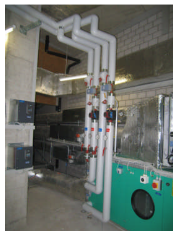
Lüftungszentrale unter dem Dach
