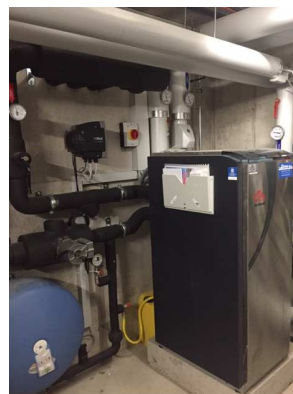
Wärmeerzeugung mit L/W-WP
